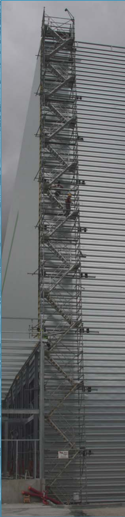
Tour escalier à volées aluminium
